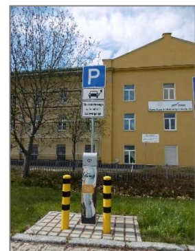
Ladestation am Bahnhof Schmölln
